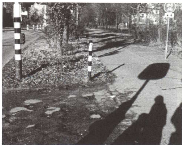
Wagenweg oversteek bij Van Oldenbarneveltlaan. Dit is een belangrijke oversteek voor scholieren naar het Coornhert Lyceum - ‘prachtig’ hoeveel gaten er in dit stukje asfalt zich verzameld hebben.
