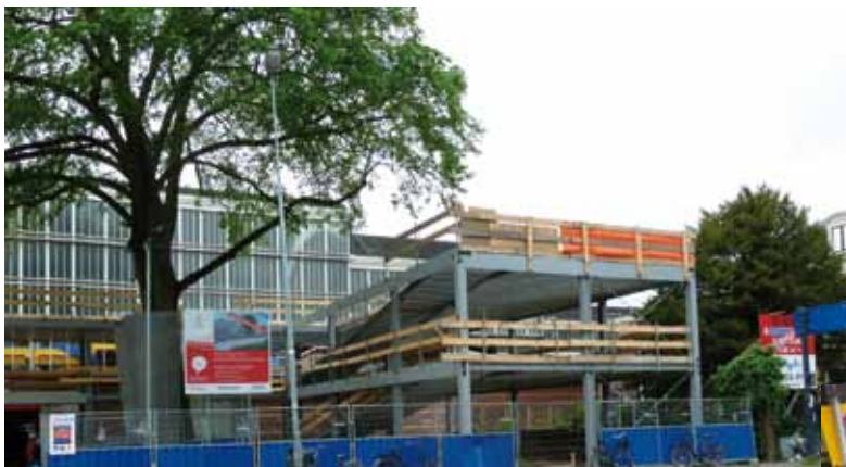
Fietsflat achter het station in aanbouw. Opening op 28 september. De hellingbanen naar de verdiepingen zijn al zichtbaar.
