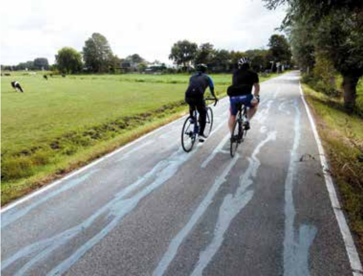
Zuid Schalkwijkerweg 'opgelapt' in plaats van opnieuw geasfalteerd.
