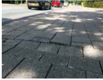
Zandvoortseweg verzakking fietspad
